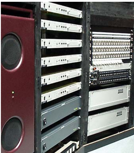
■モニター棚下ラックのSTUDER ADAユニット
