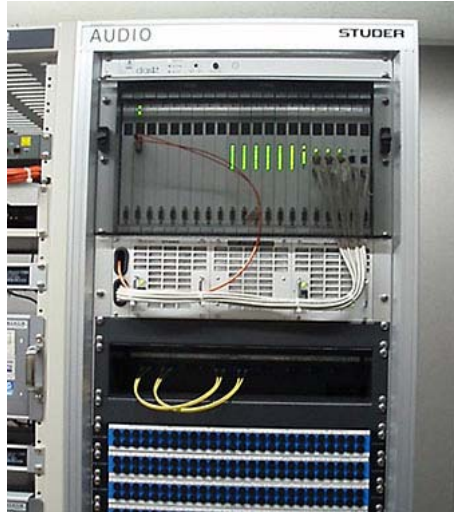
■マシンルーム内音声ラックにデジタル回線を集約
